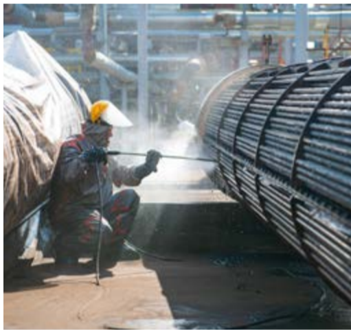
Мылка пучков теплообменника
