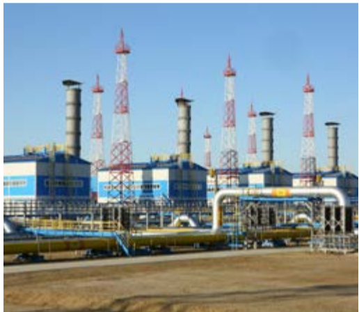
Центральная дождевая компрессорная станция Чаиндинского месторождения
